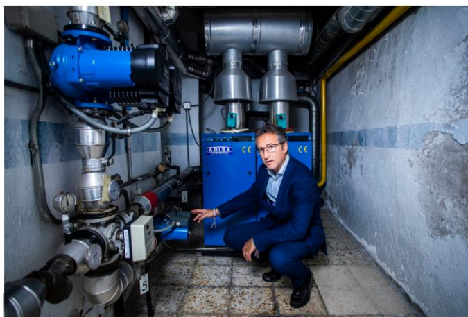
Francisco Berrocal, administrador de una finca del paseo de la Virgen del Puerto (Madrid) que ha acordado suspender el servicio de calefacción. SAMUEL SÁNCHEZ
